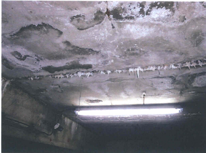
Obr. 2 - Stopy po vyzrážanej soli medzi stropnými panelmi
