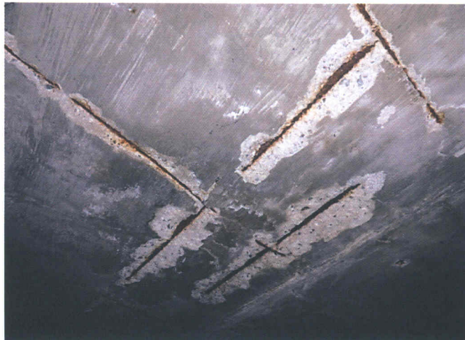
Obr. 5 - Skorodovaná výstuž bez krytia - strešný panel
