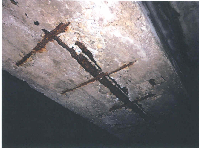
Obr. 6 - Skorodovaná hlavná aj šmyková výstuž bez krytia - prievlak
