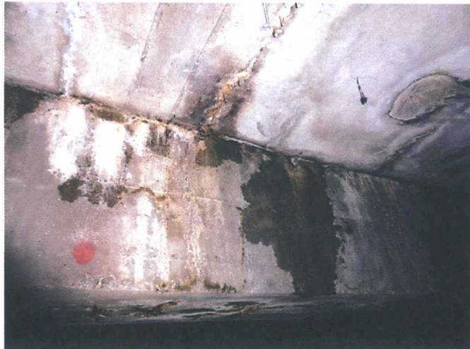
Obr. 4 - Stopy po zatekaní na prievlaku a na stropnom paneli
