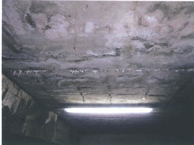
Obr. 9 - Voda okolo elektrického vedenia a svietidiel
