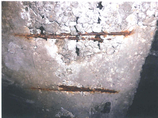
Obr. 7 - Skorodovaná šmyková výstuž bez krytia - prievlak
