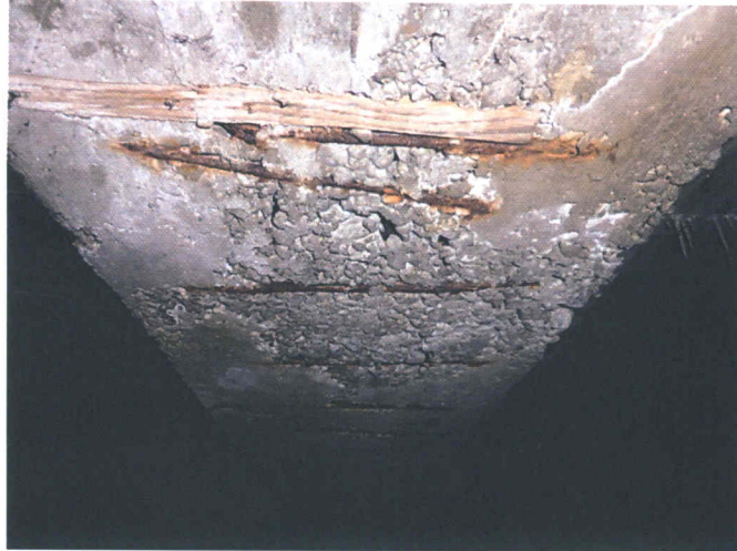
Obr. 3 - Skorodovaná šmyková výstuž bez krytia
